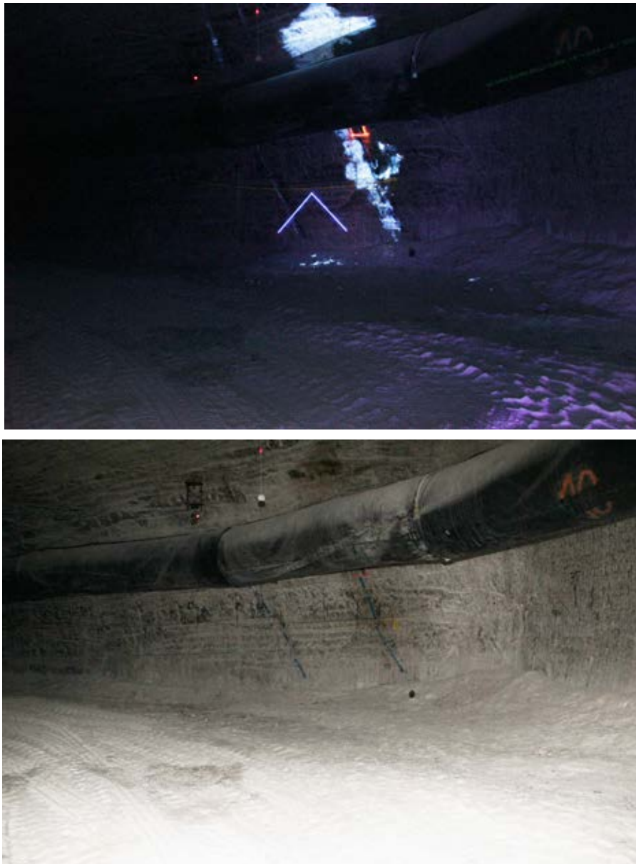
Abb. 56: Lokal auf den ehemaligen Weststoß des Bohrortes 5.0 beschränkte, größerflächige Verbreitung von KW im Kontaktbereich von KW-Band und Anhydritband unter UV-Strahlung (obere Aufnahme) und bei Kunstlicht (untere Aufnahme). Auffällig sind vor allem das boudinierte Erscheinungsbild des Anhydritbandes und die sichelartige Schliere. Oberhalb der Lutte weist die flächenhafte Verbreitung eine auffällige Keilstruktur auf, die auf zwei Schrämmspuren zurückzuführen ist (untere Aufnahme). Dieser Bereich verdeutlicht, wie die in einem kleinen Band in geringer Menge angetroffenen KW mechanisch über eine größere Fläche verteilt werden (Aufnahmen: DBE).
