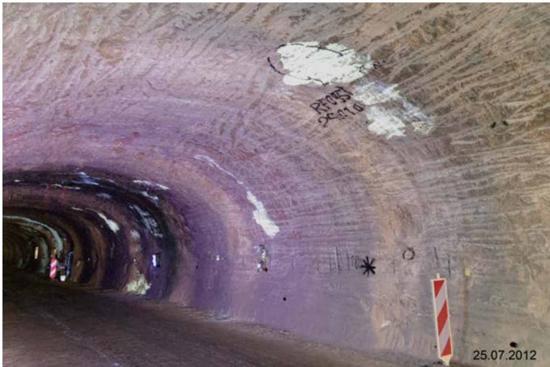
Abb. 3: Streifenartige Bereiche gelblich- bis orangefarbener Fluoreszenz am Weststoß des Q1W auf der 840 m-Sohle im Erkundungsbergwerk Gorleben. Bereichsweise treten lokal begrenzt KW (erkennbar an der weißlich-bläulichen Fluoreszenz) aus dem Gebirge aus und verteilen sich großflächig über Stoß und Firste. Dabei wird durch das schwerkraftgetriebene Herunterlaufen der KW am Stoß ein scheinbar großflächiges KW-Vorkommen suggeriert (Aufnahme: DBE).
